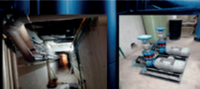
Cuarto de Máquinas, Mansión Solis Hotel & Spa
